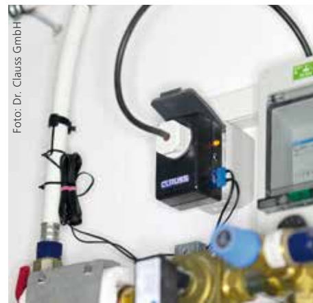
Heizungsanlage mit Zirkulationscontroller und Rohr-Messfühlern
